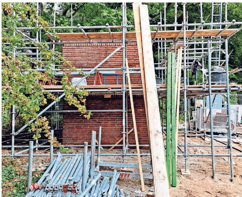
▲ Een van de twee vleermuistorens in aanbouw op het braakliggende terrein van het voormalige verpleeghuis. FOTO HELEEN DE BRUIJN
